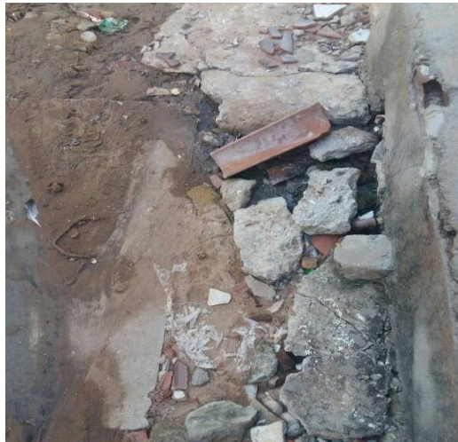
Figura 05 – Ausência de materiais de revestimentos e entulhos.
