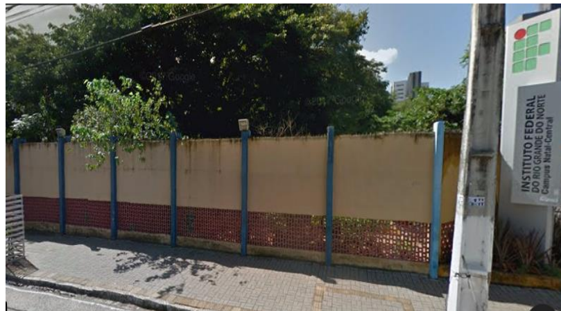
Figura 5: Antes da reforma, muro da frente no campus Natal / Central
